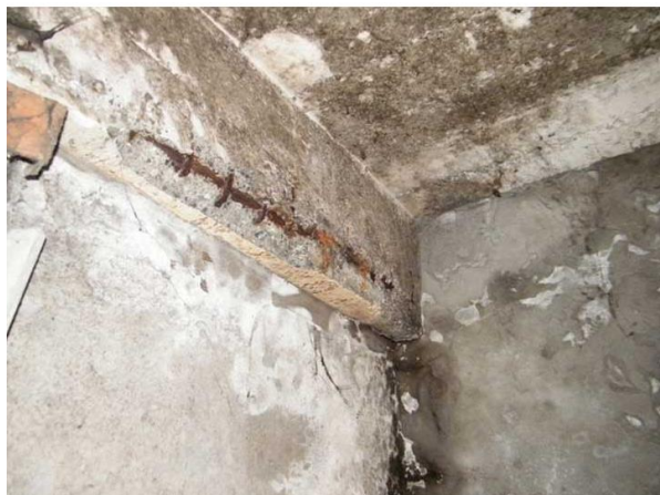
Figura 4 - Patologias causadas por umidade
