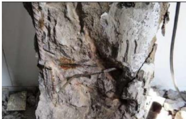
Figura 8 - Patologia em pilar causada por incêndio
