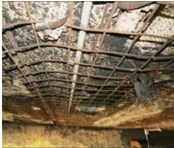
Figura 7 - Patologia em laje causada por incêndio
