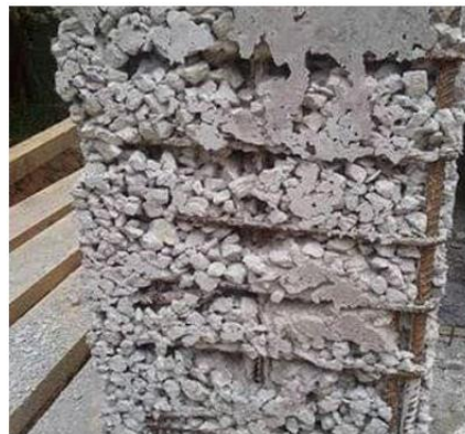
Figura 6 - Falha durante a etapa de construção
