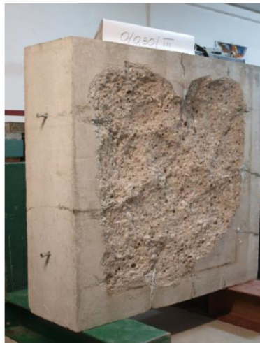
Figura 9 - Exemplo de spalling no concreto
