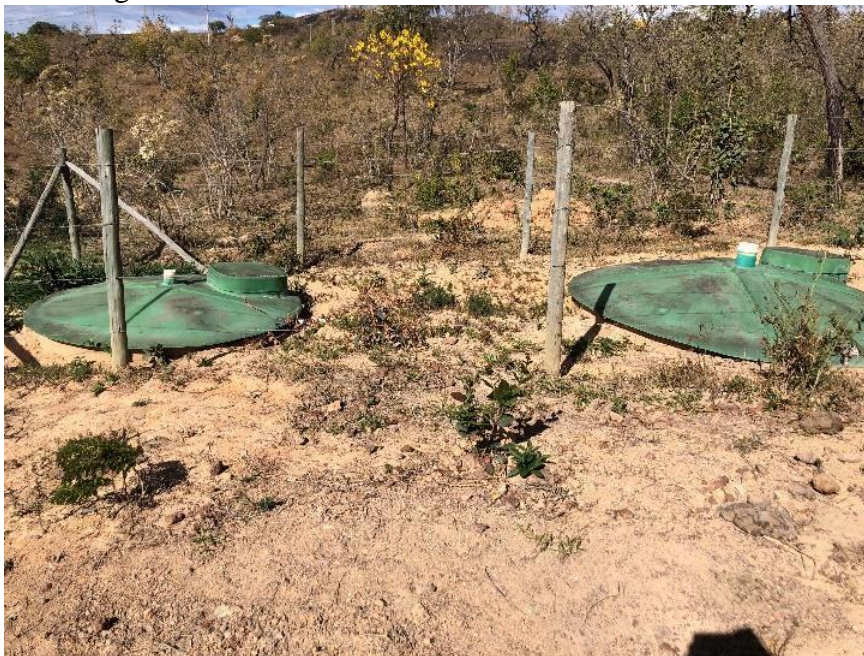
Figura 14 – ETEC localizada no loteamento Ponte Alta
