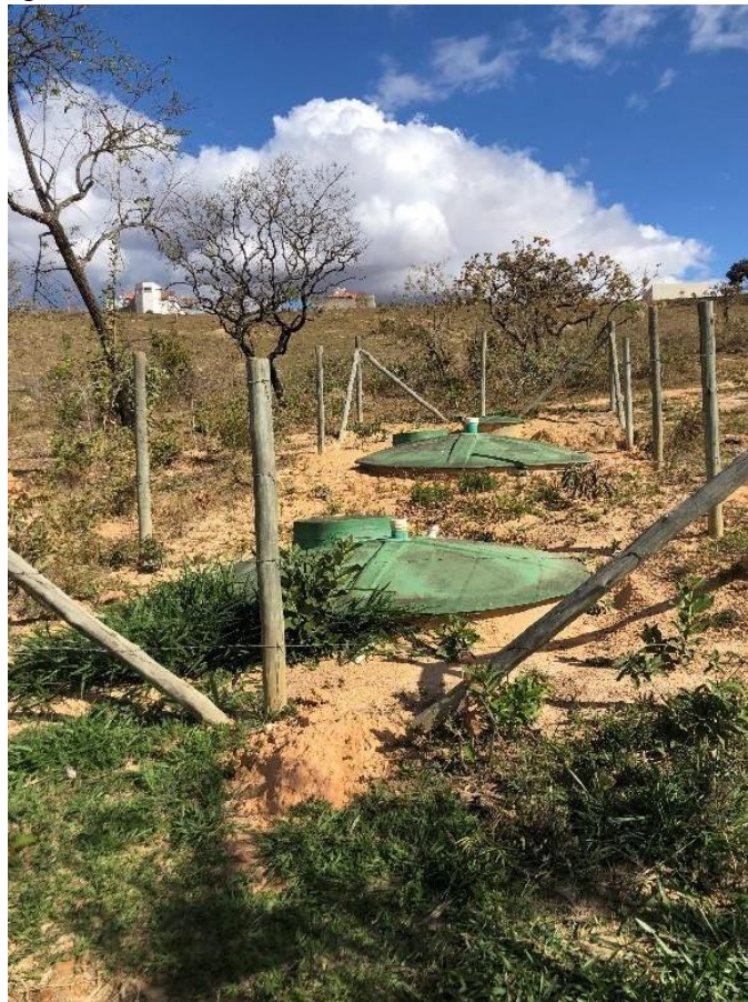
Figura 15 – ETEC localizada no loteamento Ponte Alta
