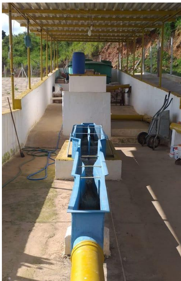
Figura 5 - Caixa de Entrada e Calha Parshall
