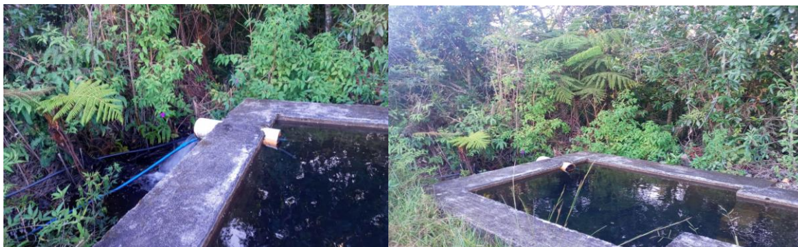
Figura 7- Estrutura de captação de água do município
