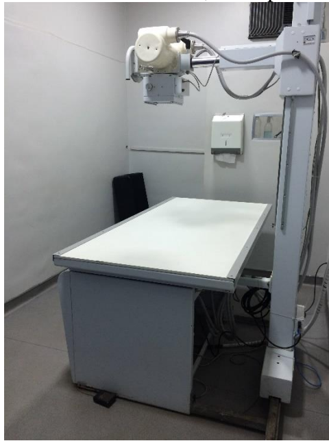
Figura 4 - Vista parcial da sala de raio-x, com aparelho com sistema DR.
