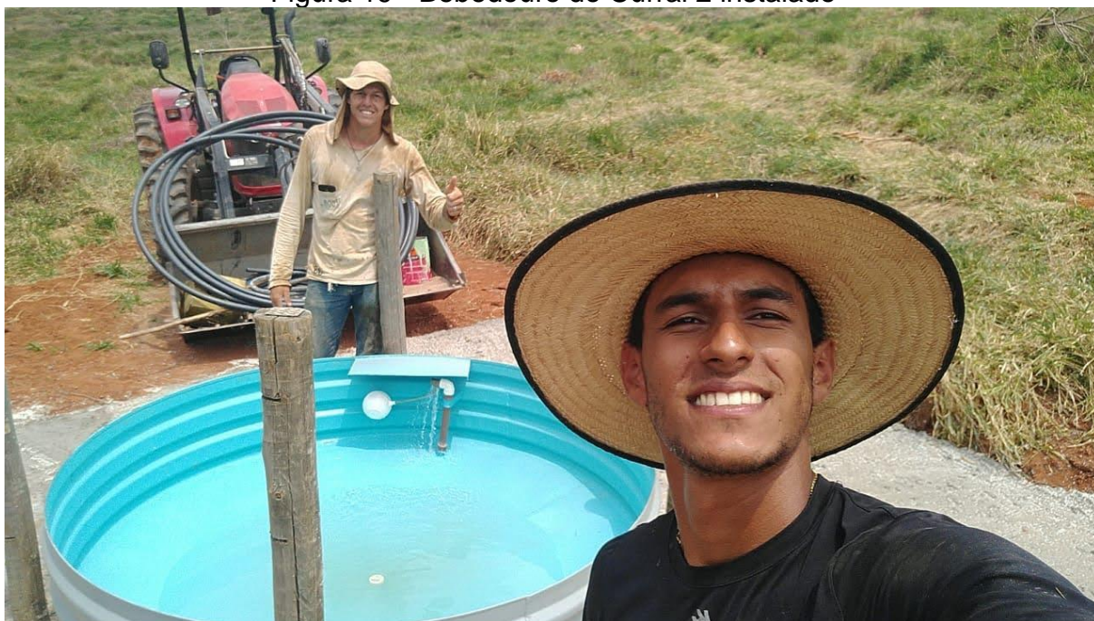
Figura 19 - Bebedouro do Curral 2 instalado
