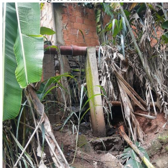
Figura 29 – Rompimento na tubulação de esgoto sanitário ponto 6.
