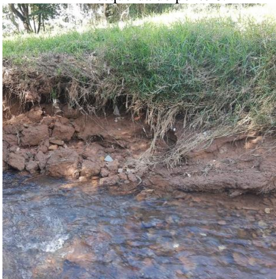
Figura 36 – Processo erosivo na margem esquerda do ponto 8.
