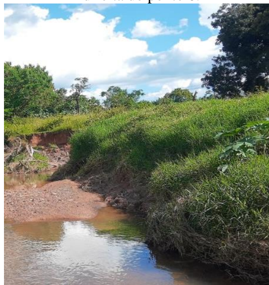
Figura 37 – Processo erosivo na margem direita do ponto 8.
