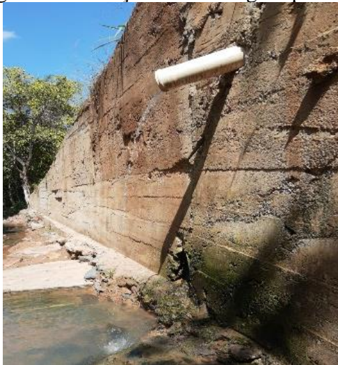
Figura 26 – Lançamento de esgoto ponto 5.
