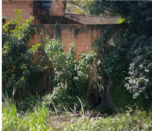
Figura 35 – Lançamento de esgoto no ponto 7.
