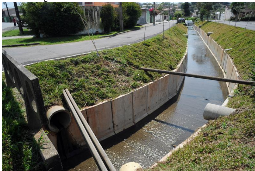
Figura 8 – Canalização do Córrego Estribo Ahú, no município de Curitiba – PR, obra de macrodrenagem urbana.
