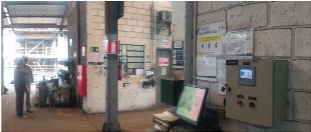
Figura 37 – Painel de monitoramento instalado
