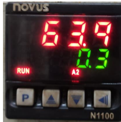
Figura 19 – Controlador NOVUS Caixa Principal
