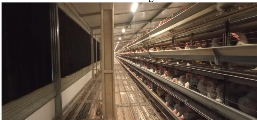
Figura 10 - Vista interna de um dos galpões de dois andares com ventilação por pressão negativa.
