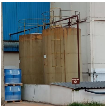
Figura 28 - Reservatório de insumos líquidos.
