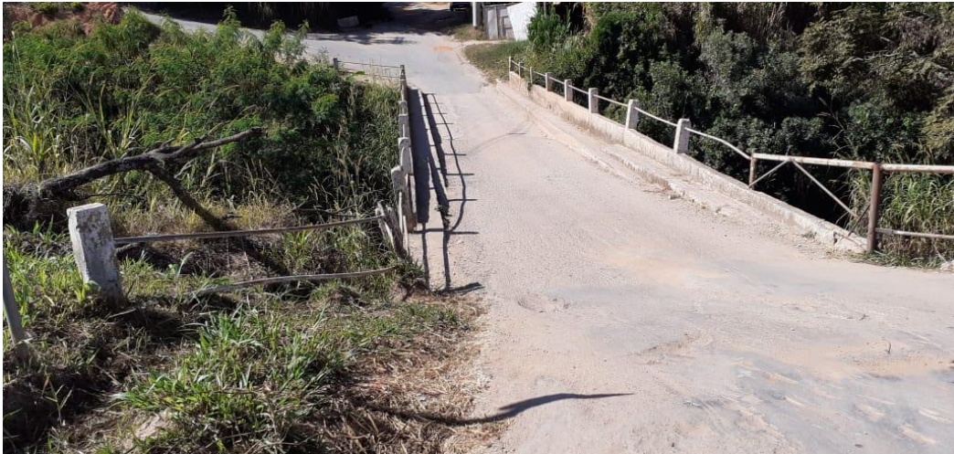
Figura 7 – Situação da ponte sob a linha férrea no bairro Barro Preto em Oliveira.
