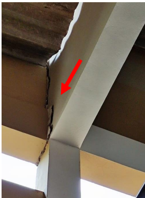
(b) Fissuras: foto tirada na parte interna da edificação.
