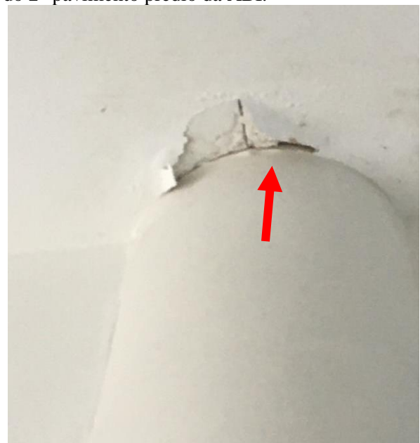
(c) Infiltração: fissura identificada na laje.
