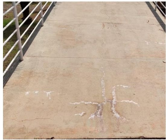
(c) Eflorescência encontrada na parte superior da rampa.
