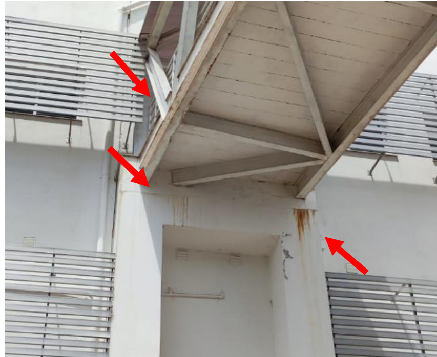
Figura 28 - Corrosão em Estrutura Metálica.
