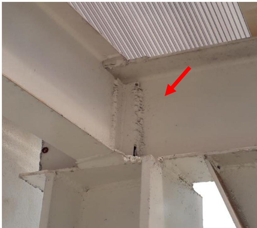
Figura 30: Defeito em ligação soldada
