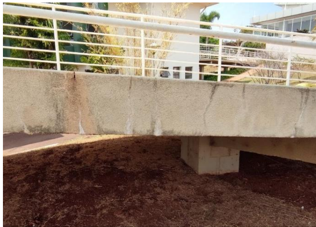
(b) Eflorescência representada na seção vertical da rampa.
