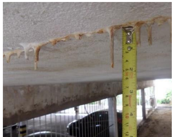
Figura 4 - Estalactites formadas devido ao fenômeno de lixiviação.
