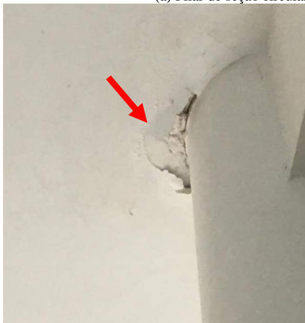
(b) Infiltração: Estufamento da tinta e fissura apresentada na laje.
