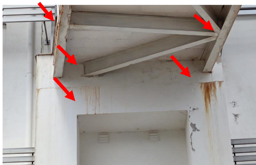
Figura 29 - Corrosão em perfis metálicos.
