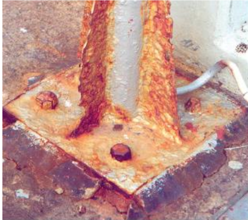
Figura 12 - Elemento metálico sob corrosão agressiva.
