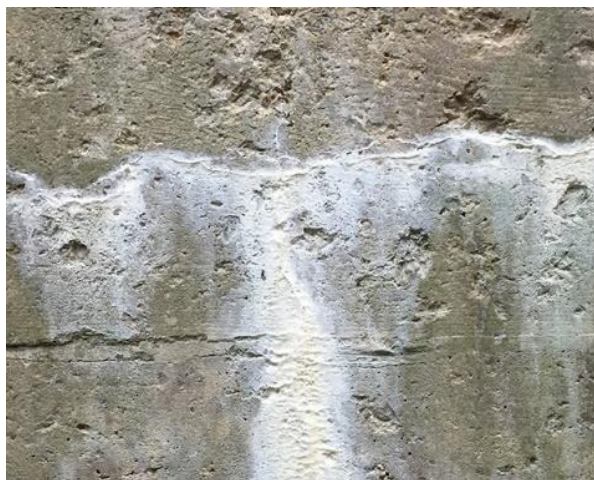
Figura 3 - Manchas brancas na superfície do concreto.
