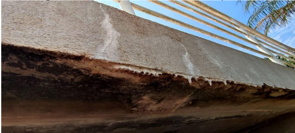
(a) Eflorescência encontrada embaixo da rampa, situada na saída do Restaurante Universitário da UFLA.
