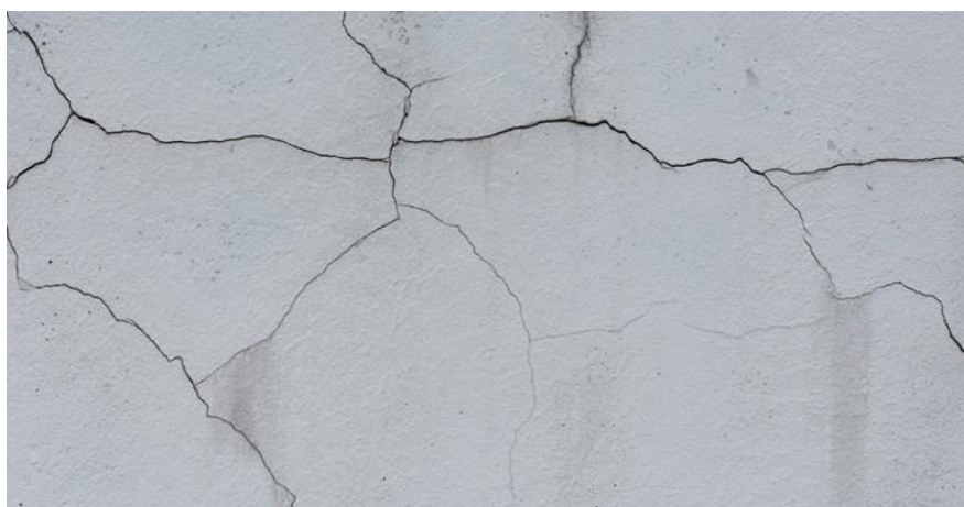
Figura 20 – Fissuras mapeadas em revestimentos argamassados.
