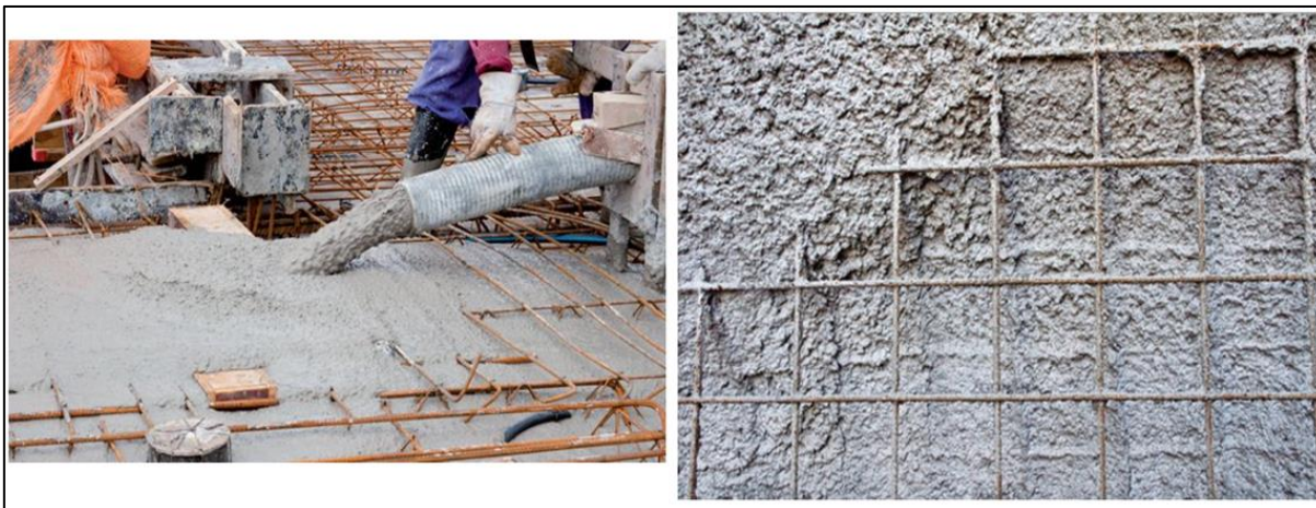
Figura 1- Mistura de cimento, areia e água (componentes da argamassa) aplicada à armações de aço com fios de pequeno diâmetro.
