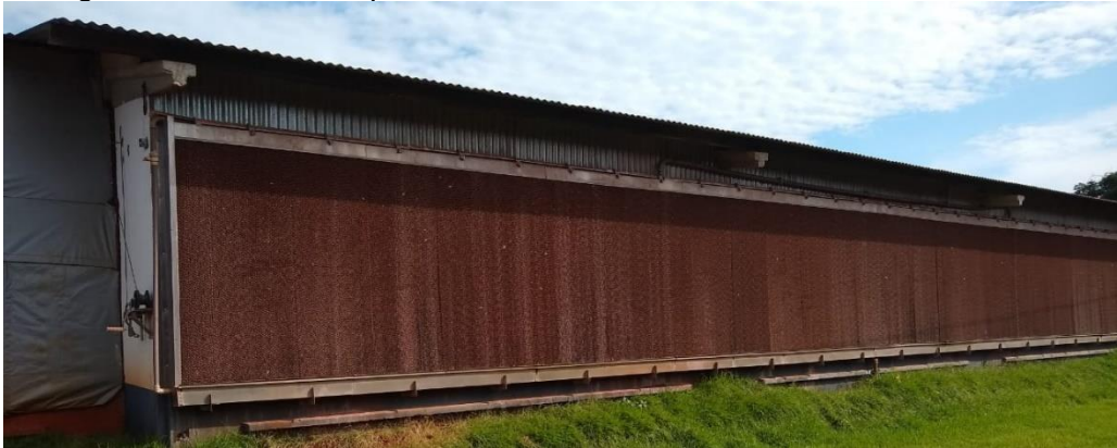
Figura 21 - Placas evaporativas em aviário climatizado - JBS/Sidrolândia
