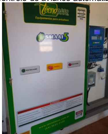
Figura 16 - Painel de controle de aviários automatizados - JBS/Sidrolândia
