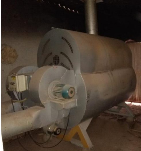
Figura 19 – Fornalha a lenha para aquecimento aviários - JBS/Sidrolândia
