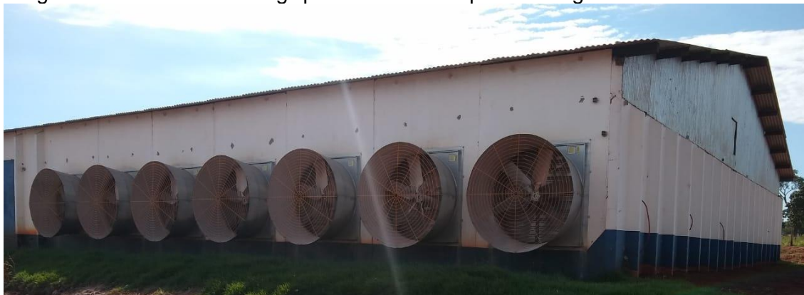
Figura 20 – Exaustores em galpão de aves com pressão negativa - JBS/Sidrolândia
