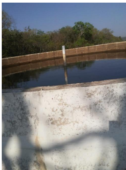
Figura 6 – Reservatório de água.
