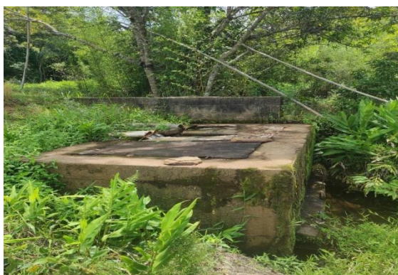
Figura 6– Estrutura de captação da água bruta
