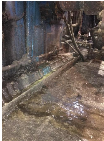
Figura 11 – Vazamento de óleo nos castelos
