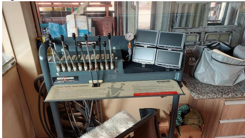
Figura 6 – Central de comando do tronco hidráulico.
