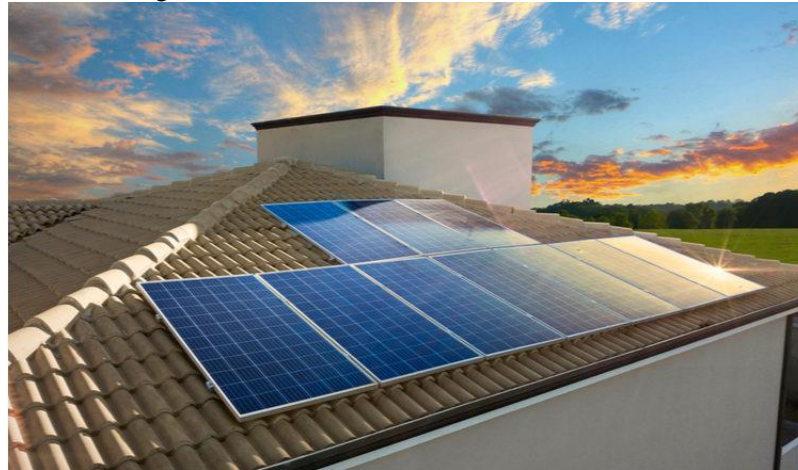
Figura 2.6 - Sistema fotovoltaico fixo instalado
