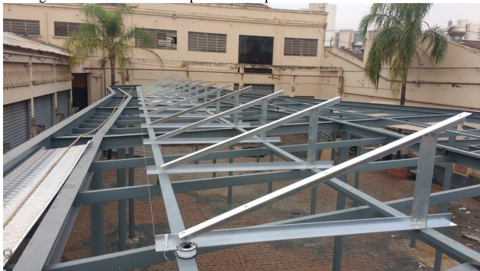
Figura 2.5 - Estrutura de suporte de um painel solar fotovoltaico
