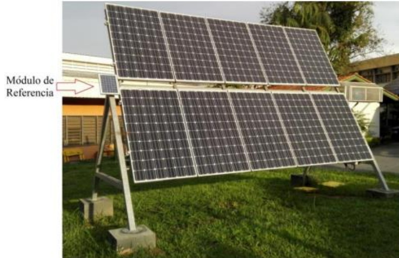
Figura 2.7 - Sistema fotovoltaico móvel instalado
