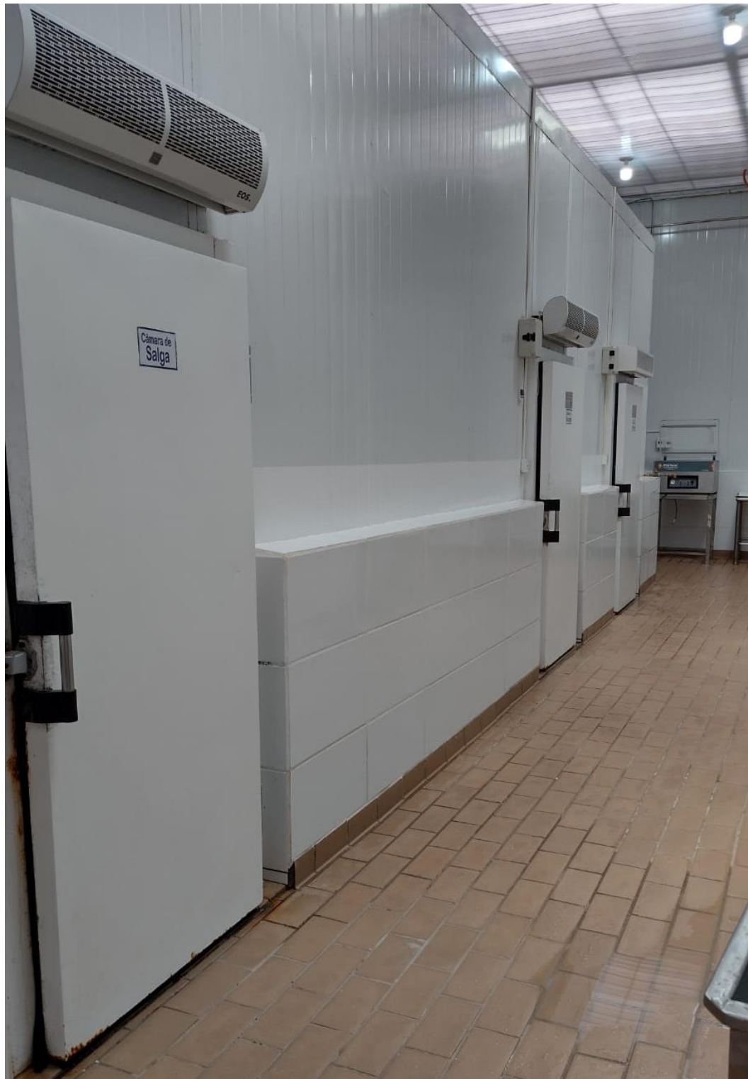
Figura 6 – Entrada das câmaras frias de salga, secagem e maturação
