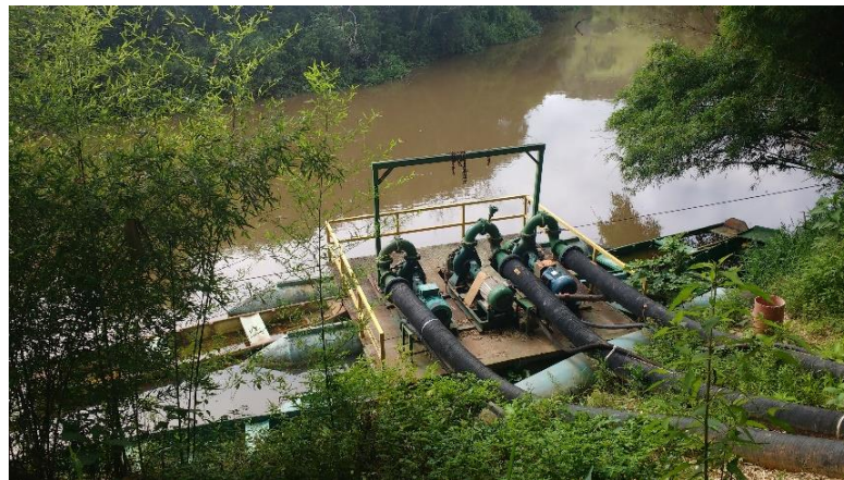
Figura 2.1 – Motobombas ETA São Lourenço.
