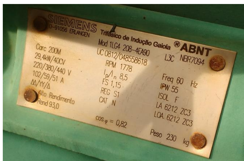
Figura 3.1 – Dados de placa da motobomba na ETA de São Lourenço.
