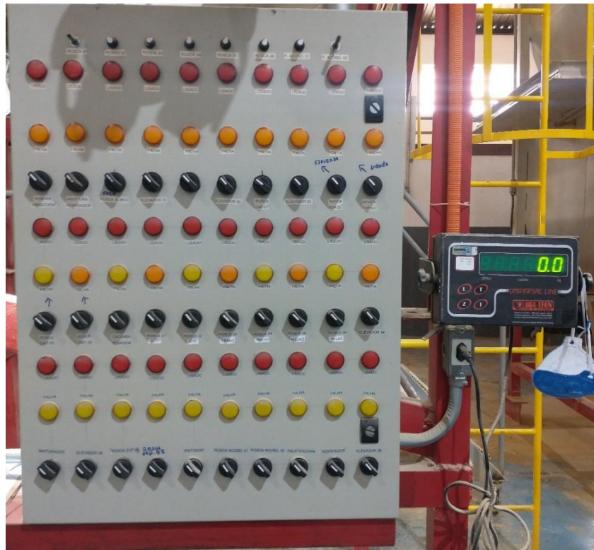
Figura 9 – Painel de controle do conteúdo dos silos
