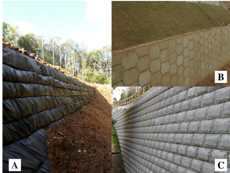
Figura 2 - Exemplos das formas construtivas da face: (A) autoenvelopada, (B) placas de concreto e (C) blocos segmentados.
