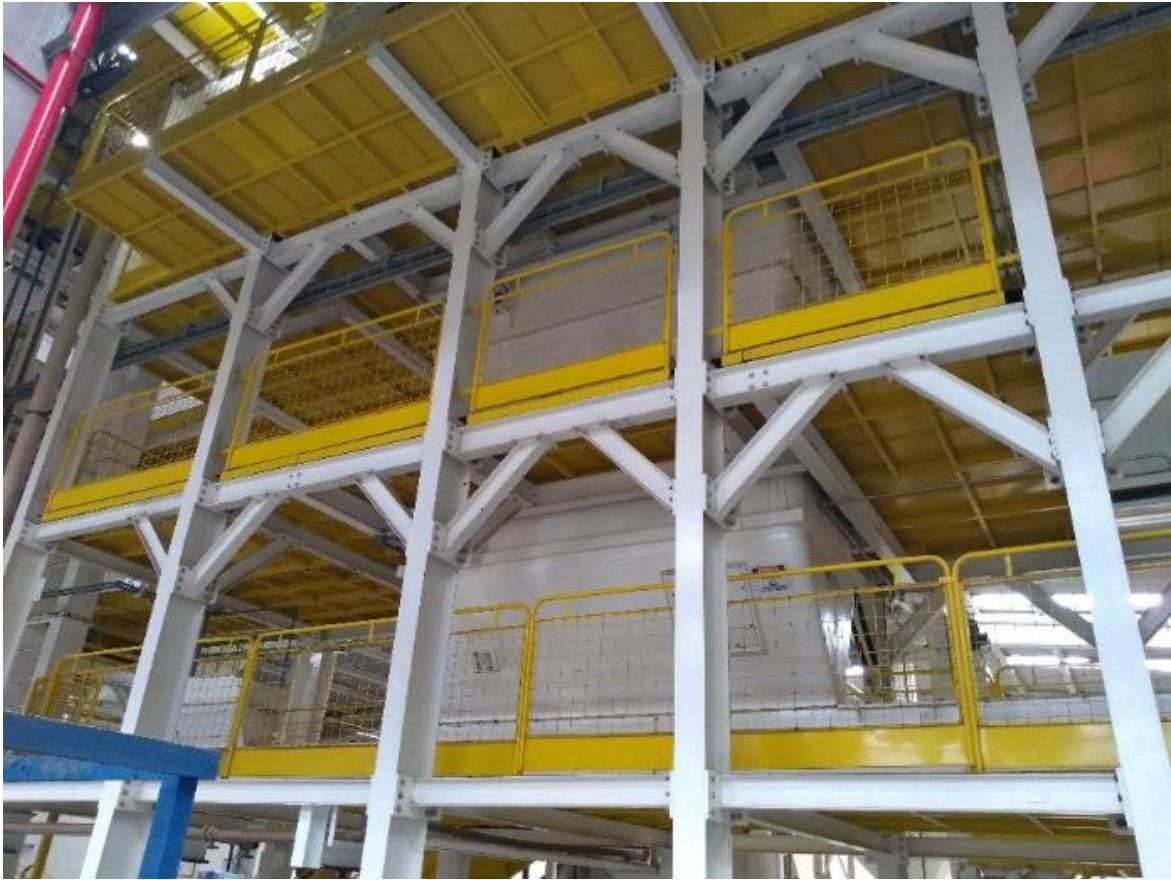
Figura 5 Vista parcial dos silos e misturador
