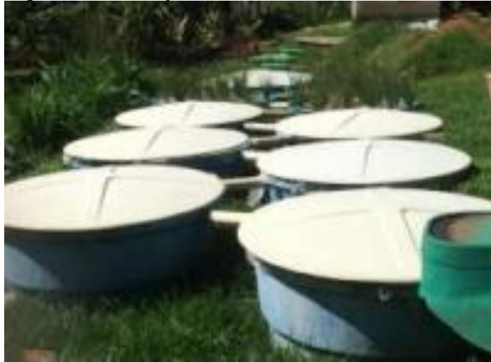
Figura 9- Tanques de decantação secundária da unidade de tratamento do PFA
