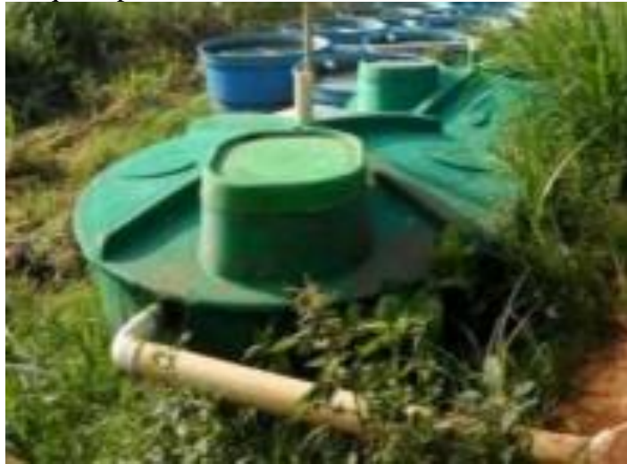
Figura 7- Tanque séptico-filtro anaeróbio da unidade de tratamento do PFA
