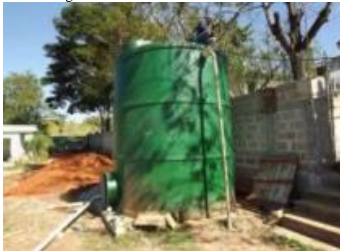
Figura 8- Filtro biológico aerado submerso da unidade de tratamento do PFA
