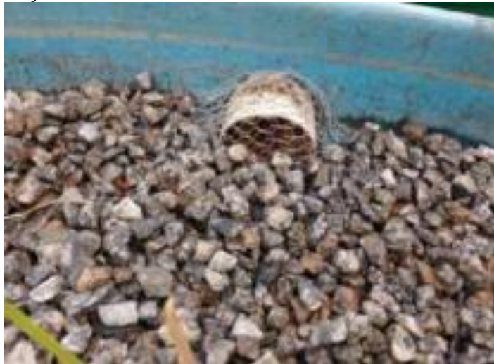
Figura 15- Instalação dos SACs no Parque Francisco de Assis com as britas e tela de proteção.
