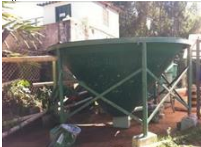
Figura 6- Decantador da unidade de tratamento do PFA
