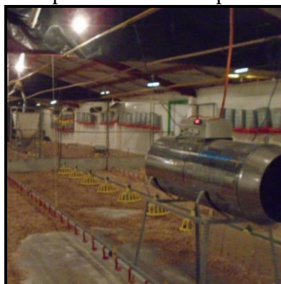
Figura 4 – Aquecedor utilizado para manter a temperatura do galpão como um todo.
