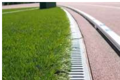
Figura 5.17 – Ralo para captação de água entre os solários.
