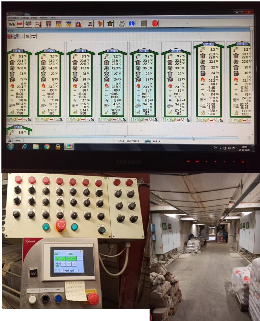
Figura 8 – Tela com informações do sistema de monitoramento de cada casa de galinha, painel de controle da esteira de ovos localizados na “pakkeri” e painéis de controle localizados do corredor de acesso às casas – Barkholt.
