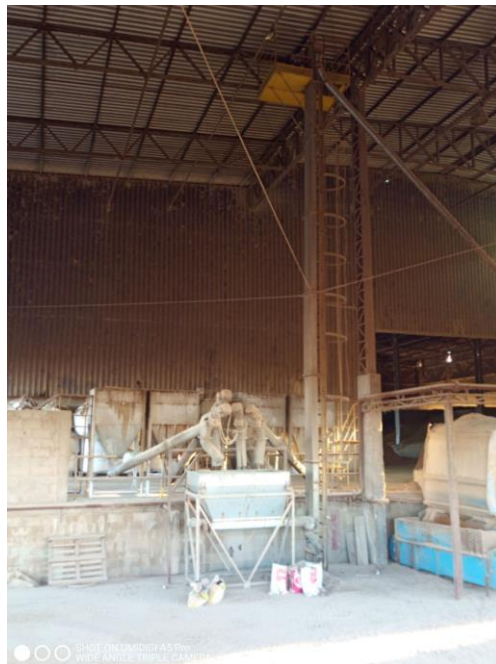
Figura 13 - Silos e balança para fornecimento de núcleo
