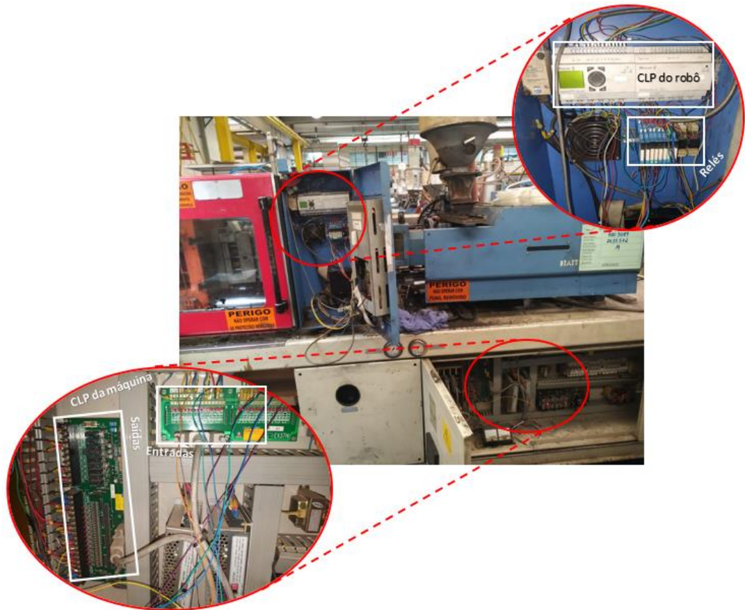
Figura 33 - Painéis da injetora.
