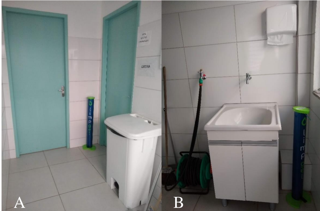
Figura 20– Ante-sala do internamento de animais com doenças infecciosas, com dispenser de álcool em gel 70% com acionamento por pedal, lixeira para material contaminado (A) e tanque para higienização de mãos com dispenser de sabão com acionamento por pedal (B).
