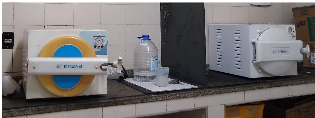
Figura 27 – Bancada de apoio da sala de esterilização.
