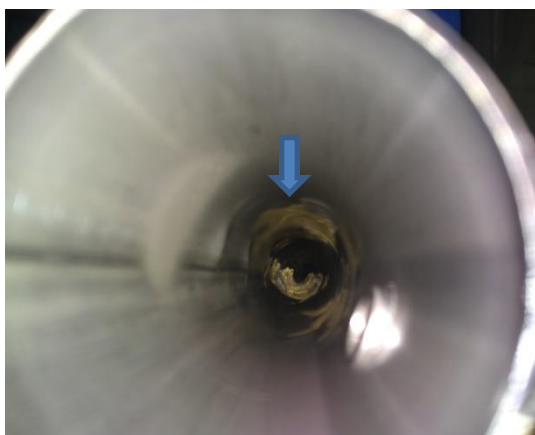
Figura 13 - Resíduos sólidos no interior do tubo. (Evidenciado pela seta azul).
