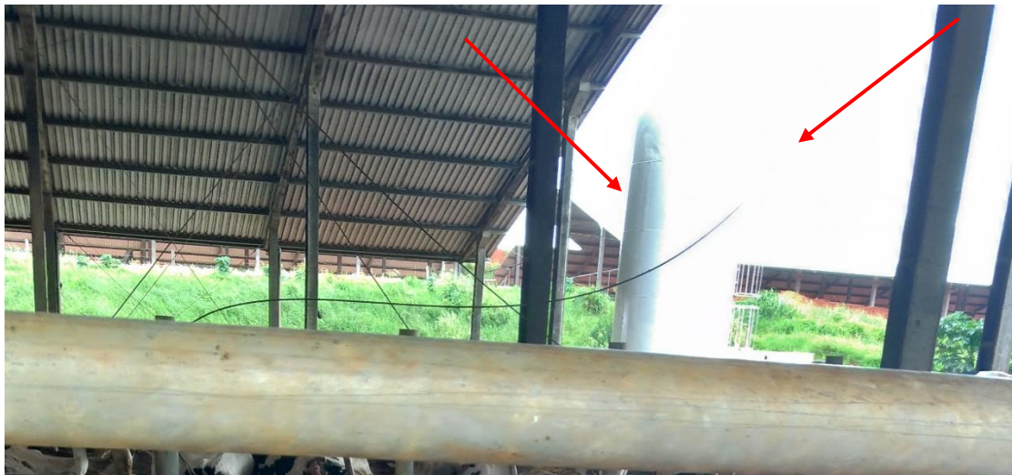
Figura 15- Parte da caixa de reservatório do chorume para uso posterior no flushing.
