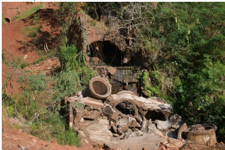
Figura 2 – Erosão no final de uma rede de galerias entre os bairros Jardim Lisboa e Parque Bandeirantes, Umuarama - PR.
