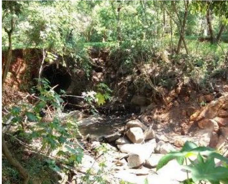
Figura 1 – Erosão causada pelo Rio do Quilombo a jusante de um bueiro sob a Rua Soldado Passarinho, Pindamonhangaba - SP.
