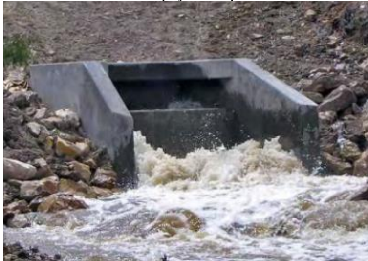
Figura 18 – Estrutura de dissipação do tipo USBR VI em atividade.
