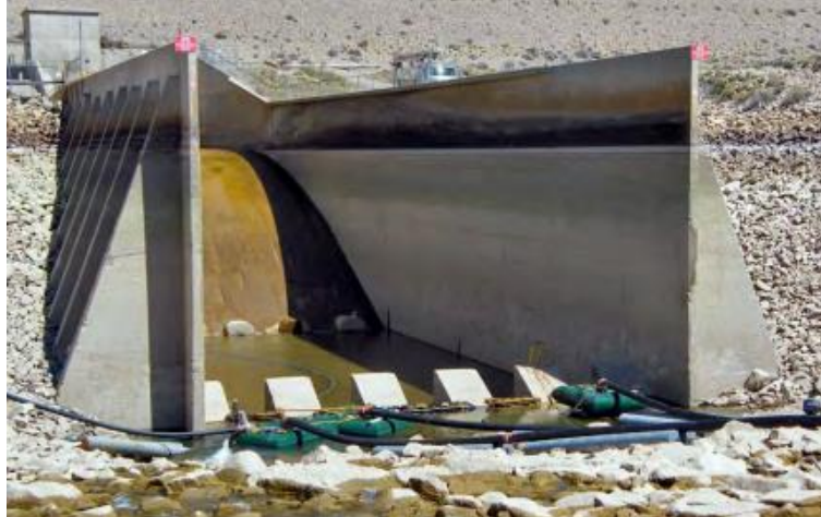
Figura 8 – Bacia do tipo USBR II sendo esvaziada para reparos.
