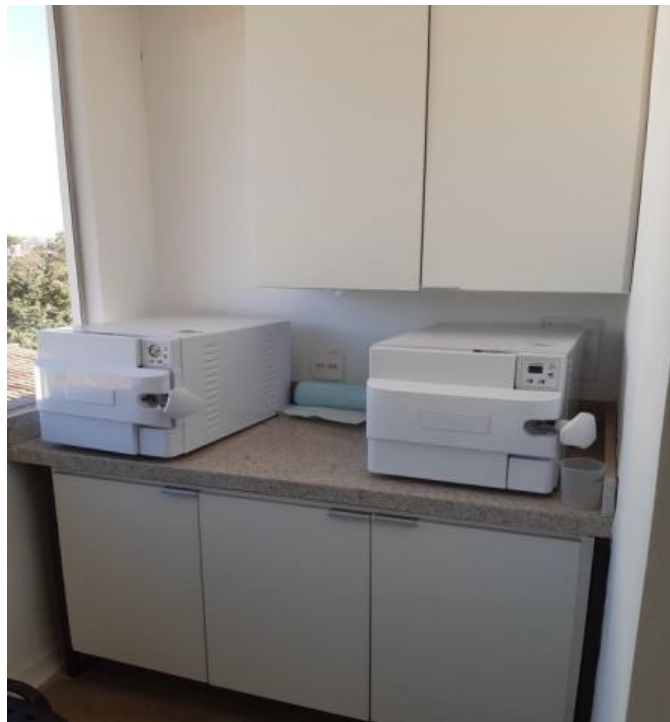
Figura 41 – Sala de esterilização de materiais cirúrgicos da Clínica Veterinária MedVet, em Belo Horizonte/MG.
