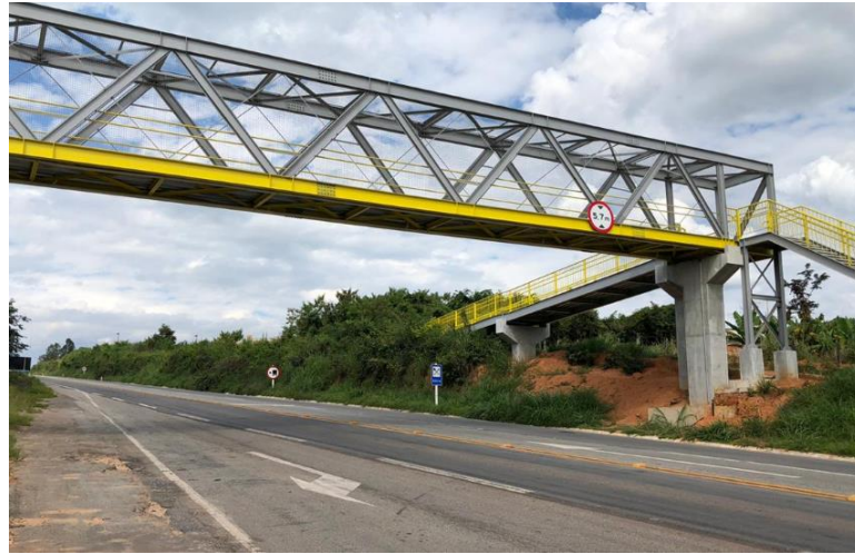
Figura 18: Estrutura da passarela sem proteção de dispositivos de proteção contínua.
