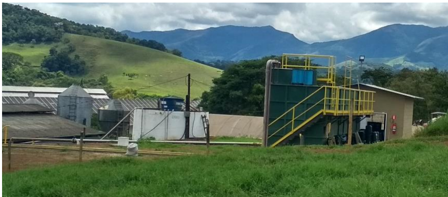
Figura 4: estação de tratamento de água
