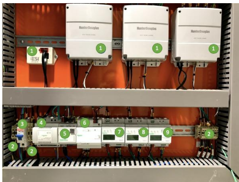
Figura 12- Quadro de Automação
