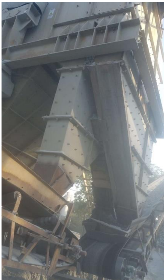
Figura 16 – Dano estrutural causado pelo atrito com o material rochoso em peneiras vibratórias.
