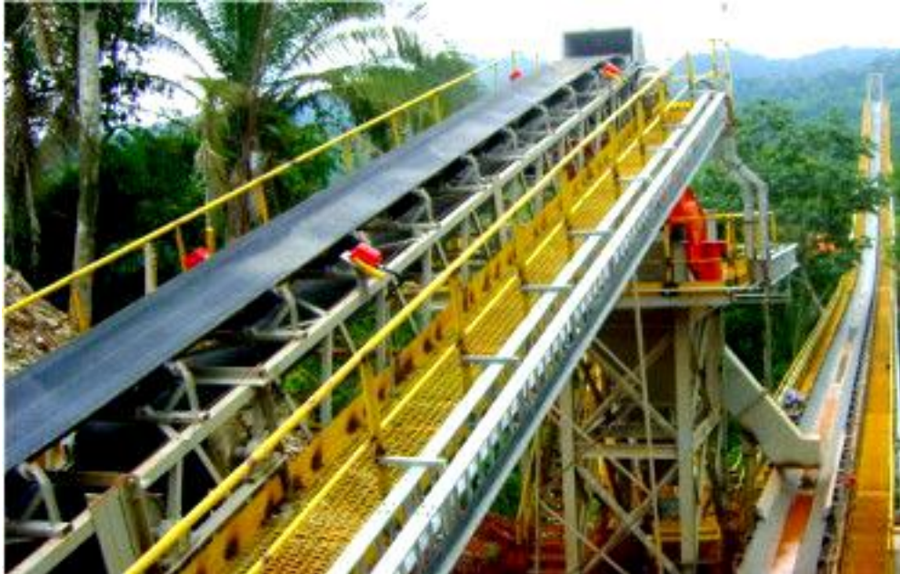
Figura 11 – Correias transportadoras, utilizadas para o transporte de brita nas plantas de britagem.
