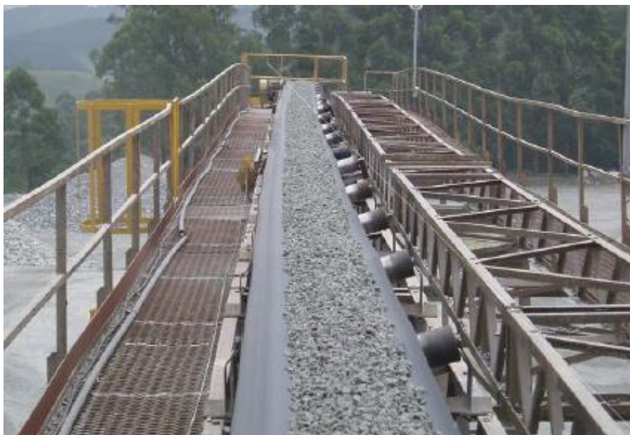
Figura 15 – Correia transportadora desalinhada, um dos principais problemas de transporte de materiais.
