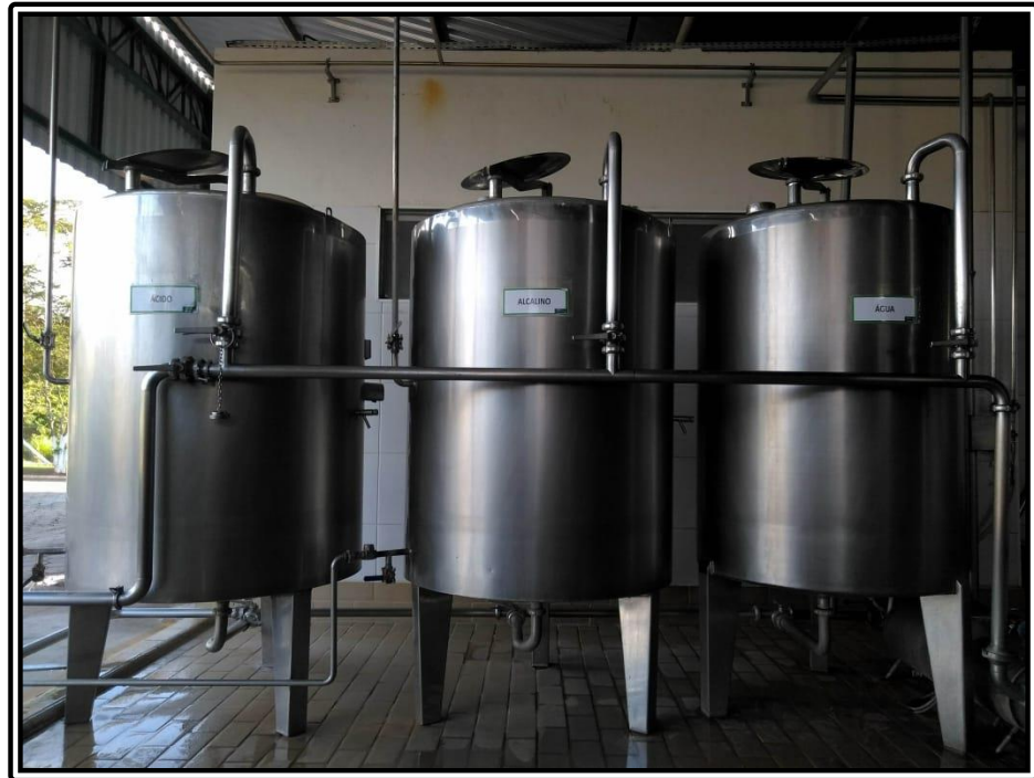
Figura 8 - Diagnóstico de situação dos caminhões. Compartimentos para armazenamento do detergente ácido, detergente alcalino e água quente, utilizados na lavagem CIP do laticínio A (MG).
