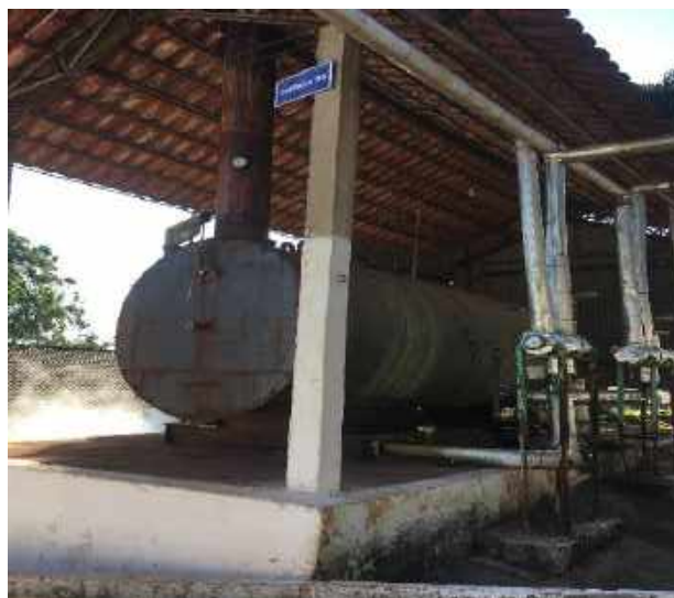
Figura 4 – Caldeiras de aquecimento.
