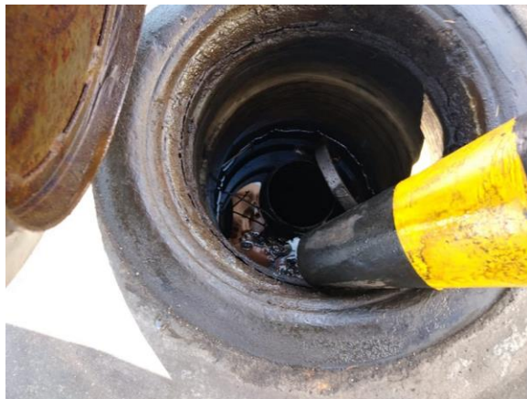
Figura 25 - Coletor de OLUC gerado localizado no subsolo em postos de combustíveis.
