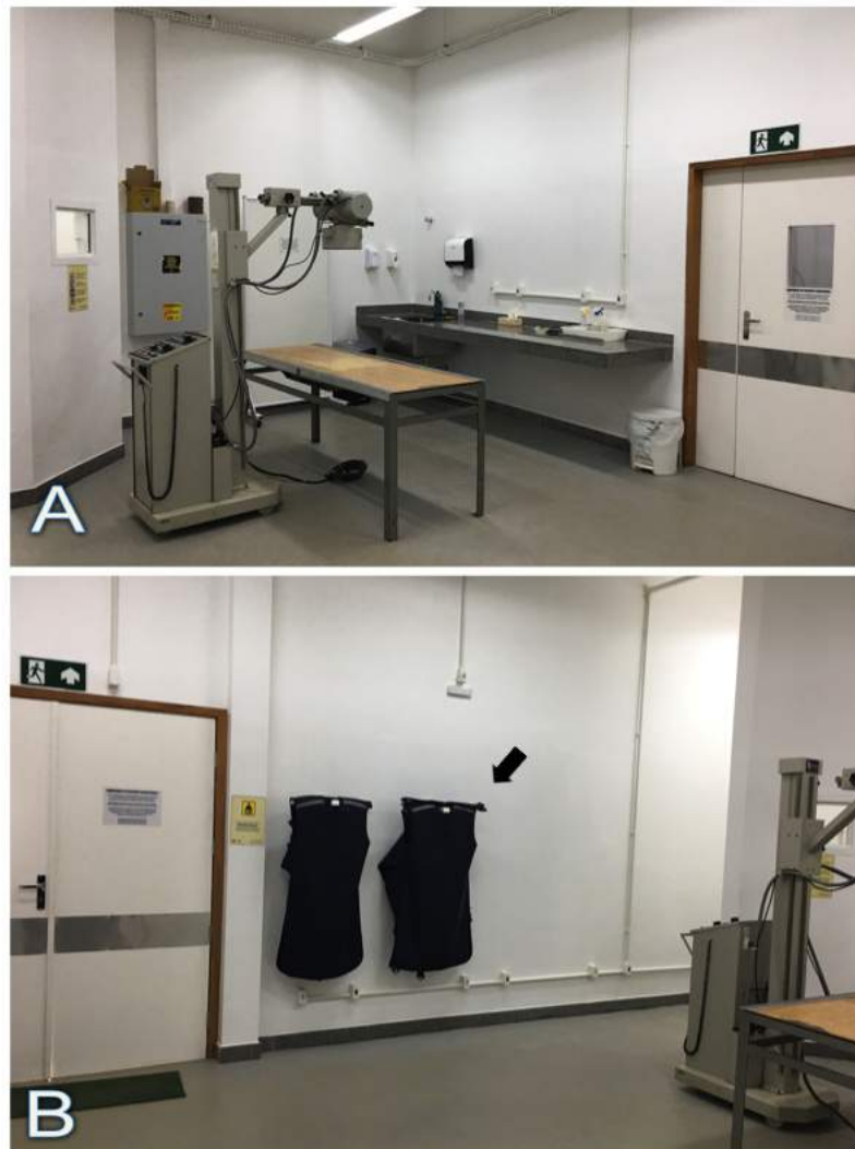
Figura 12 – Sala de radiologia do Hospital Veterinário da Universidade Federal de Viçosa. A) Lado direito da sala de radiologia. B) Lado esquerdo da sala de radiologia com vestimentas plumbíferas (seta preta).
