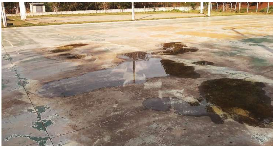
Figura 5 – Acúmulo de água na quadra poliesportiva do “Brejão”
