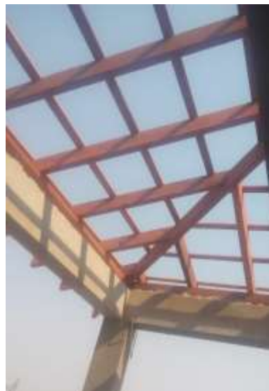
Figura 4. Madeiramento de telhado de residência em Ijaci, Minas Gerais.
