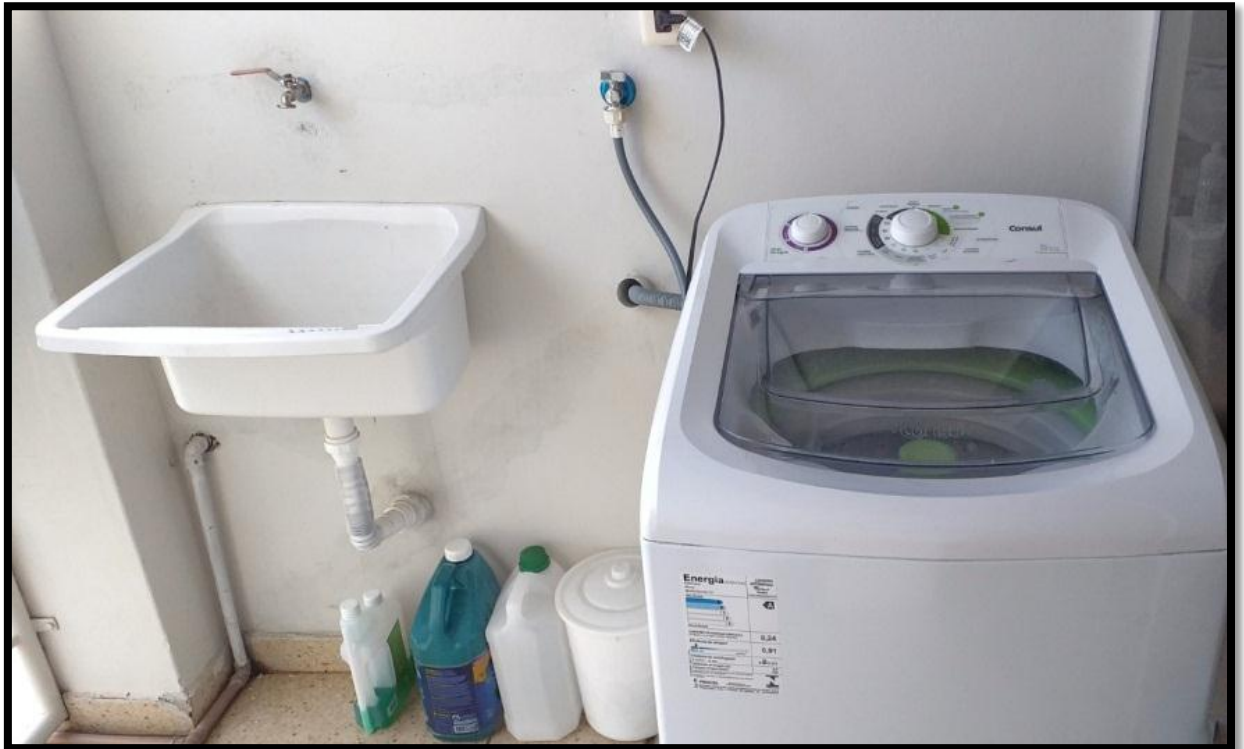
Figura 9 - Vista parcial da lavanderia da clínica veterinária Vet & Pet – Lavras/MG.
