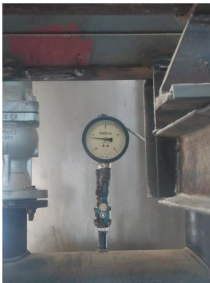
Figura 11. Manômetro da válvula controladora de pressão de vapor.
