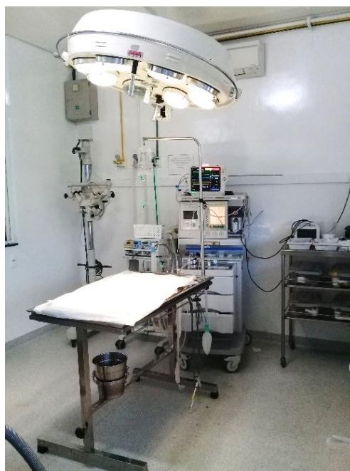
Figura 12 - Vista frontal do centro cirúrgico 02 do Hospital Veterinário Cães e Gatos 24 Horas, em Osasco/SP.
