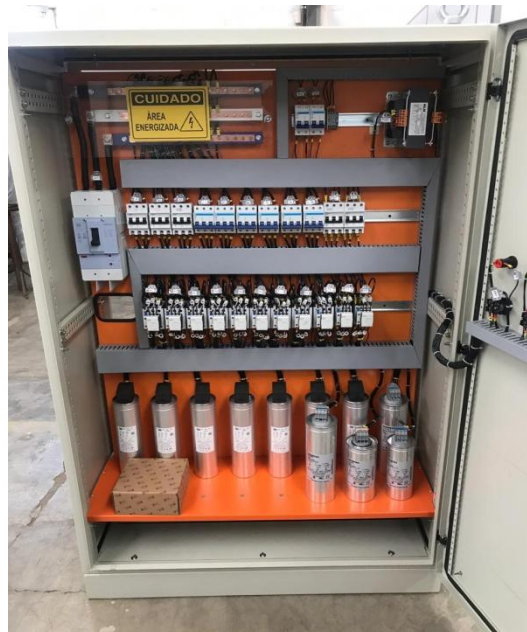
Figura 12: Banco de capacitores (potência)
