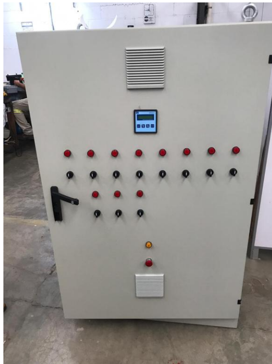
Figura 16: Banco de capacitores (comando)
