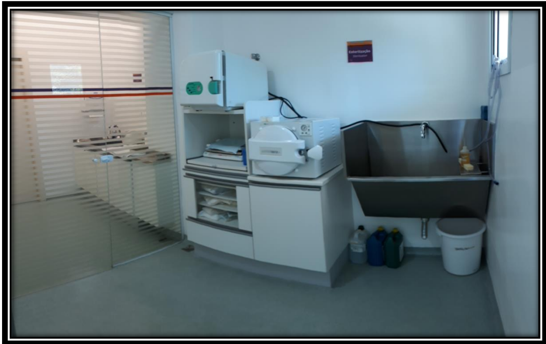
Figura 4: Sala de Paramentação Cirúrgica contendo uma pia para lavagem das mãos, duas autoclaves para esterilização de roupa e materiais e um armário para armazenamento de materiais esterilizados; Hospital Veterinário H-Vet Terapia Intensiva Animal, Alphaville Burle Marx, Santana de Parnaíba/SP, Fevereiro de 2019. Fonte: Da autora, 2019.
