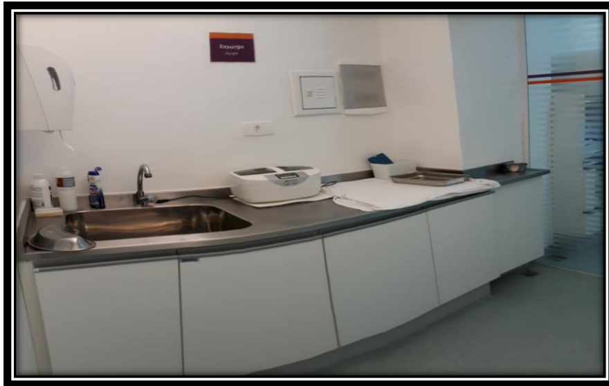
Figura 6: Sala de expurgo contendo uma pia para lavagem de materiais, equipamento eletrônico para limpeza e desinfecção de instrumentais cirúrgicos, armário para armazenamento de materiais e produtos usados para limpeza e desinfecção dos materiais cirúrgicos utilizados; Hospital Veterinário H-Vet Terapia Intensiva Animal, Alphaville Burle Marx, Santana de Parnaíba/SP, Fevereiro de 2019. Fonte: Da autora, 2019.
