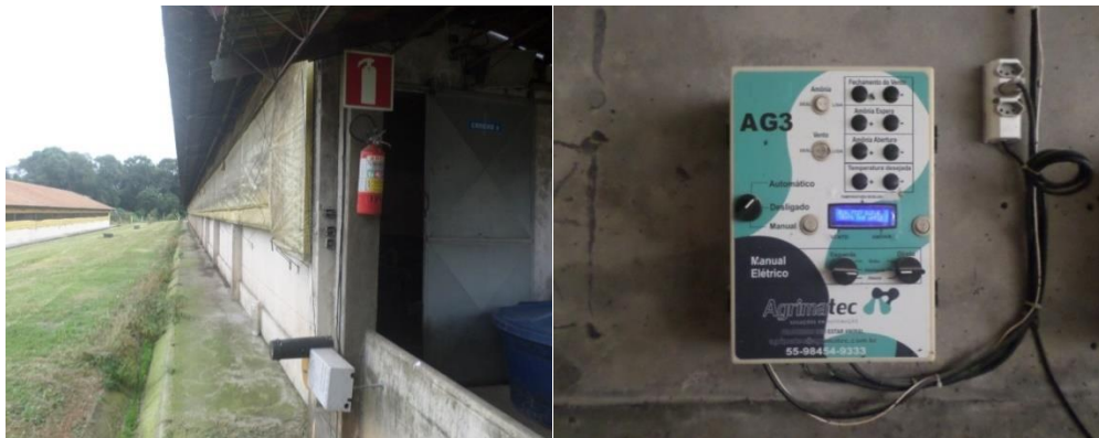
Figura 8. Sistema automático de acionamento da cortina.
